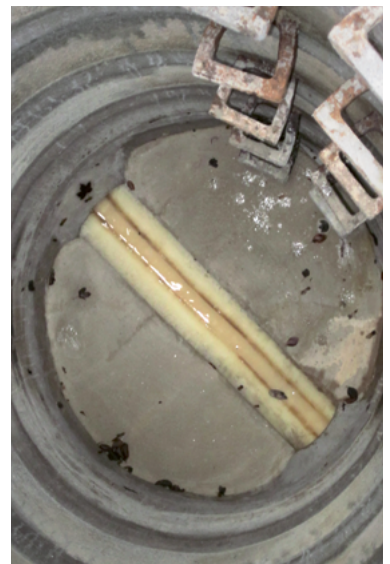
Linerdurchführung im Schacht
