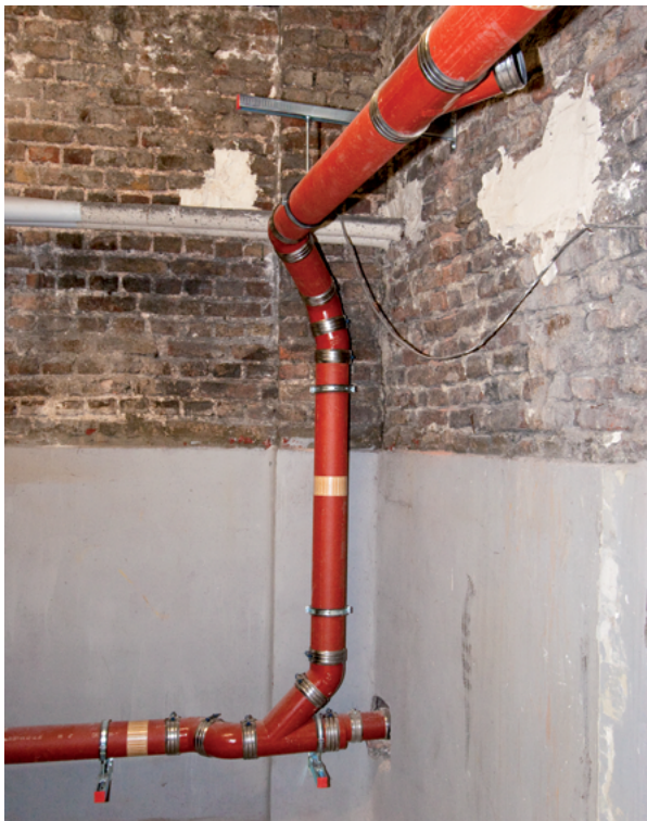
Abgehängte Leitungen an der Kellerwand
